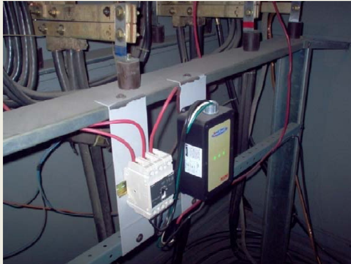
SUPRESOR LA ST180 3Y1C TABLERO PRINCIPAL TORRE 2
