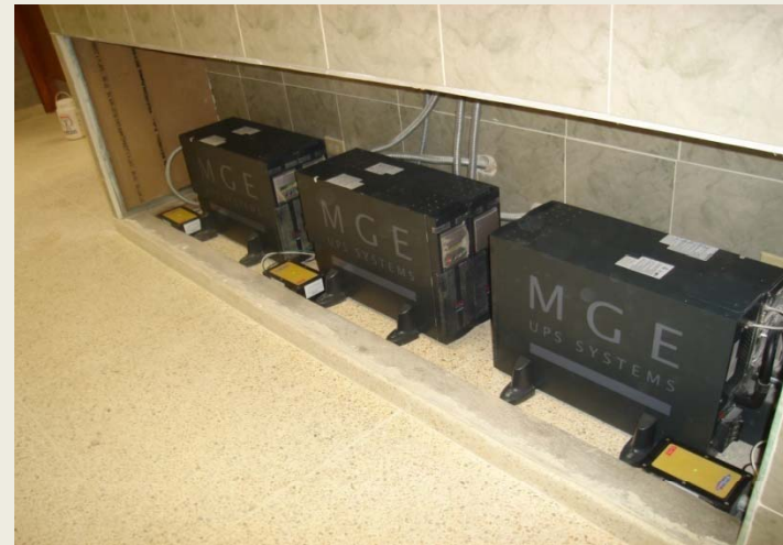
PROTECCION DE UPSs
