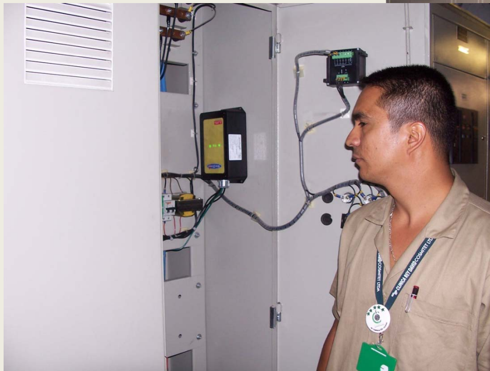
SUPRESOR LA ST120 3Y1C EN TABLERO DE DISTRIBUCION
