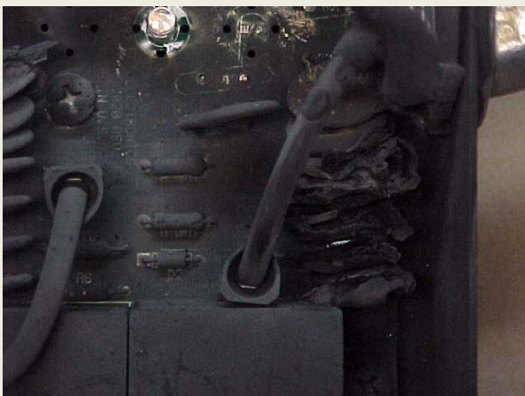
DESTRUCCIÓN Fallas catastróficas
