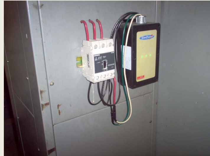
SUPRESOR LA ST120 3Y1C TABLERO PRINCIPAL TORRE 1
